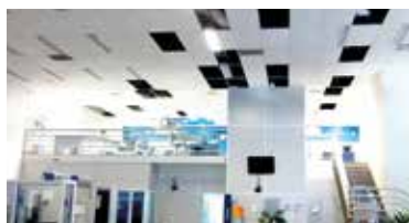
Buracos onde deveriam ter placas térmicas no forro da agência Vila Tibério
