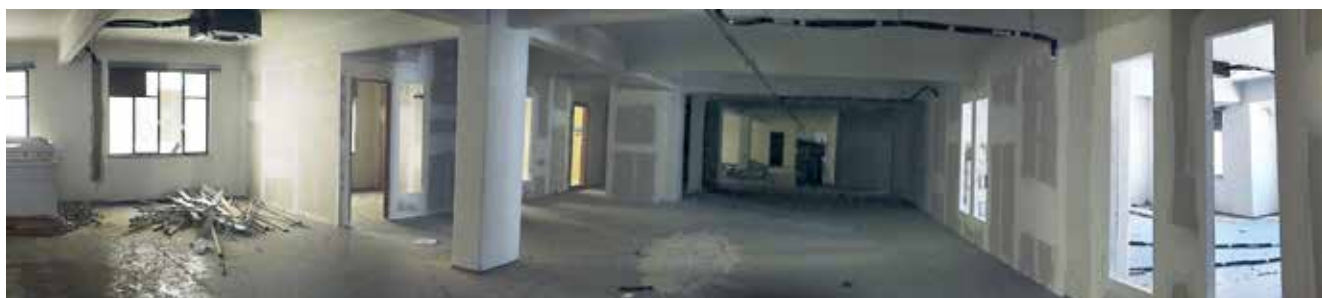
Reforma do novo espaço adquirido pela APCEF/SP para instalação dos departamentos administrativos e financeiros da entidade
